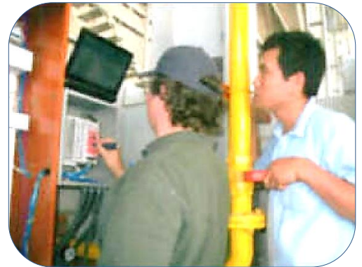
Theo dõi hệ thống béc đốt / Burner system monitoring
