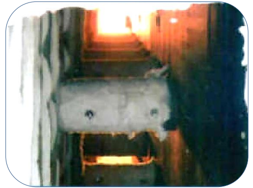
Bên trong buồng đốt / Side in combustion chamber
